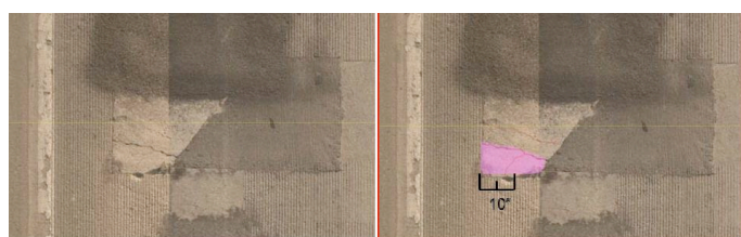
図 3-7 コンクリート・パッチングの ひび割れ と うき (Stage III) 左：高解像度可視画像、右： ひび割れ と うき の範囲の表示。
